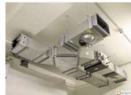
системы дымоудаления и противодымной вентиляции
